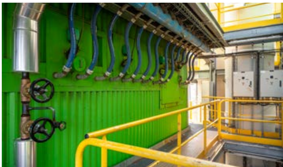
Traitement des oxydes d'azote dans les fumées.
