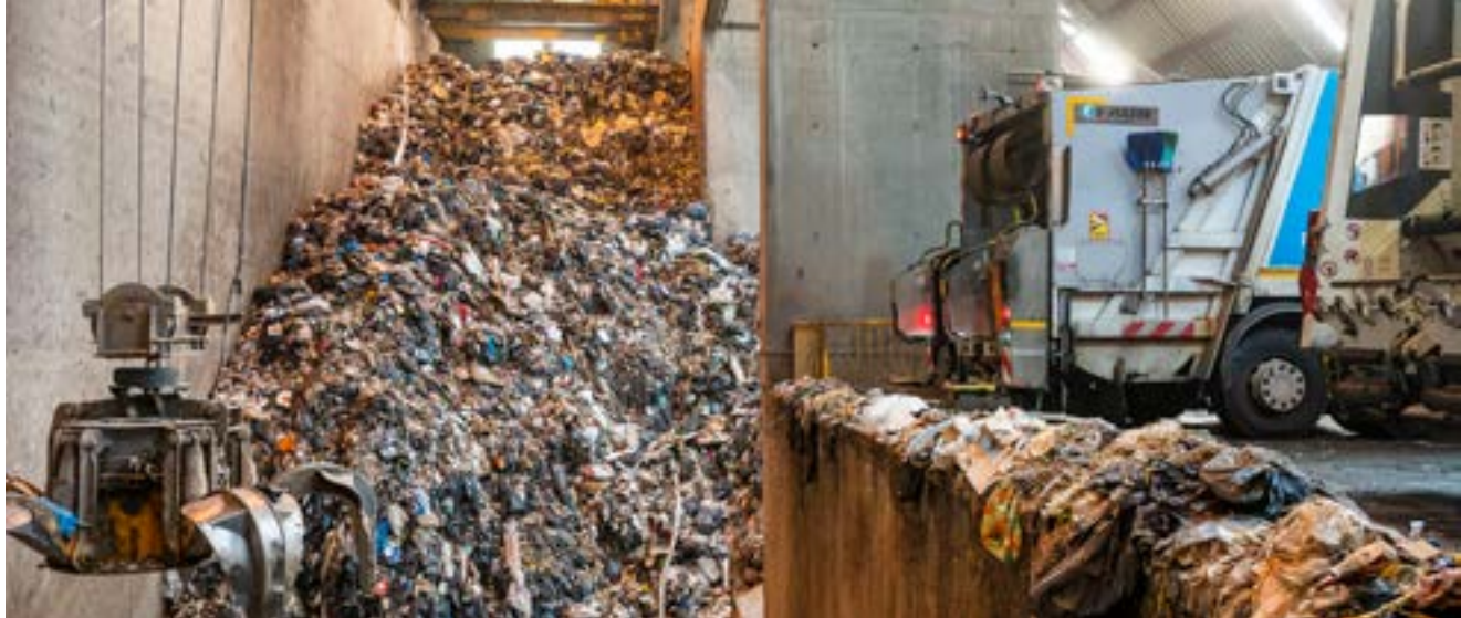
Fosse de réception des ordures ménagères - UTVE Lyon Sud.
